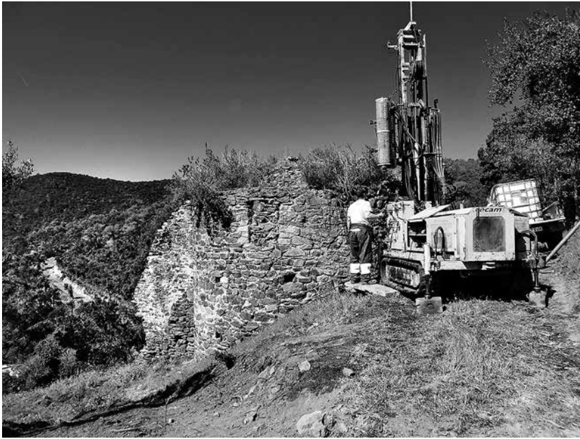
Fig. 5. Fotografia d'un dels diversos sondeigs que es feren a l'entorn de l'edifici per comprovar l'estabilitat del terreny.
