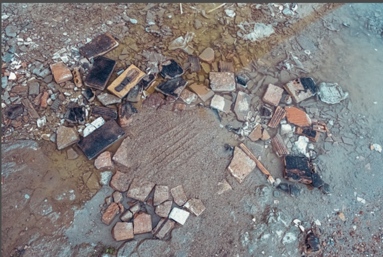
>> Detalls de la degradació acumulada.
