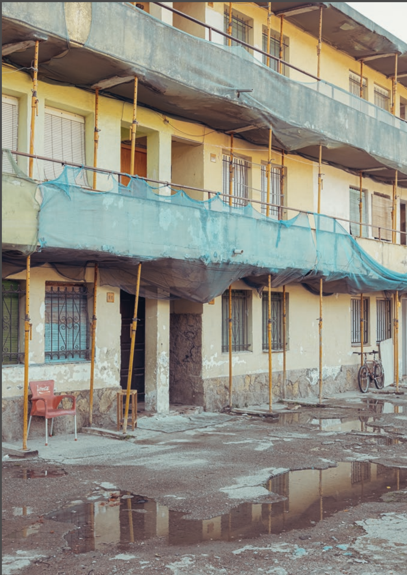
>> La façana dels pisos, apuntalada amb bastides i xarxes de protecció. L'estat de degradació és visible a simple vista des del carrer.
