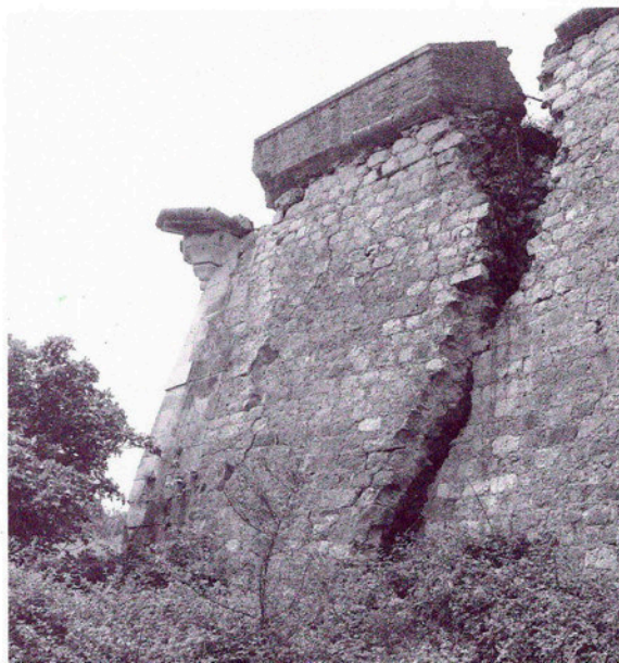
Aspecte d'una de les parets del castell de Sant Ferran afectades per l'explosió del 8 de febrer de 1939.
