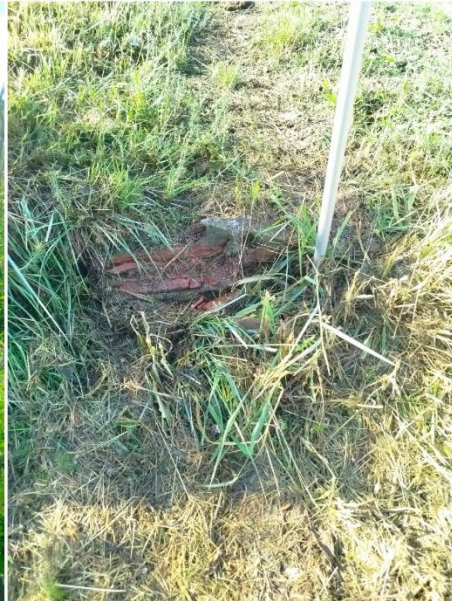
Obres de drenatge amb mal estat..
