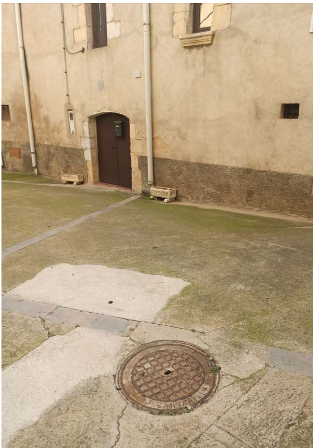
Estat del paviment de la Placeta
