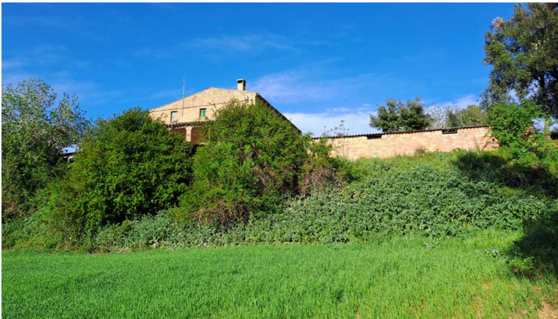
Imatge de les façanes sue-oest del volum principal mirades des del camp de baix.
