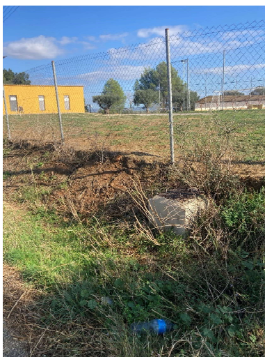
Figura 5. Arqueta escomesa existent camp de futbol
