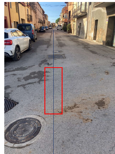
Figura 2. Àmbit actuació 2 vàlvula reguladora sector Masos
