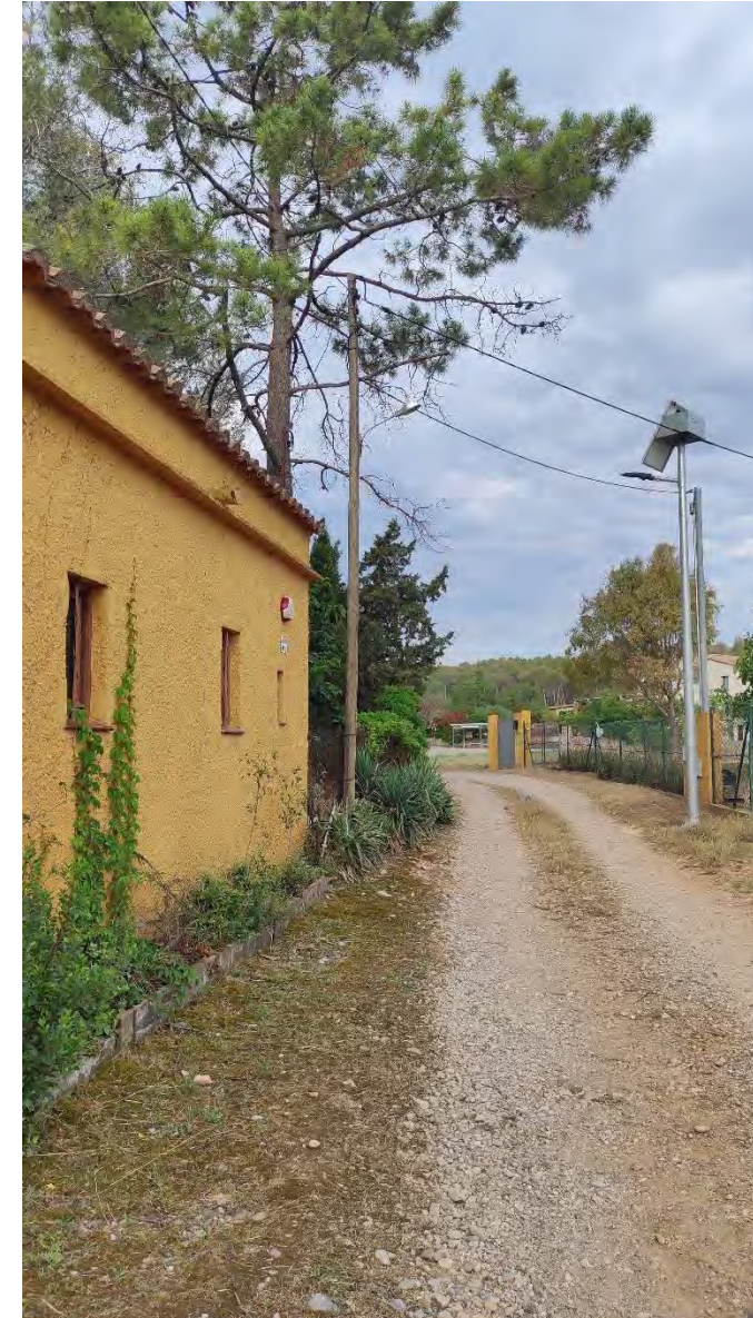
Foto3. Substitució de suport existent de de fusta per nou support de formigó HV-400-11m
