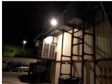
Foto 2. Ventiladors d'extracció de la línia L1 (davant) i de la línia L3 (darrera).
