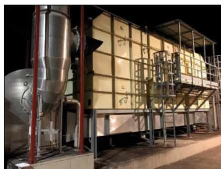
Foto 4. RTO i ventilador del RTO.
