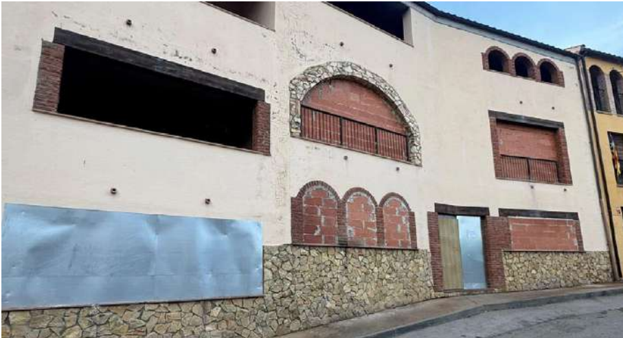
Aspecte dels pisos tapiats del carrer Santa Caterina
