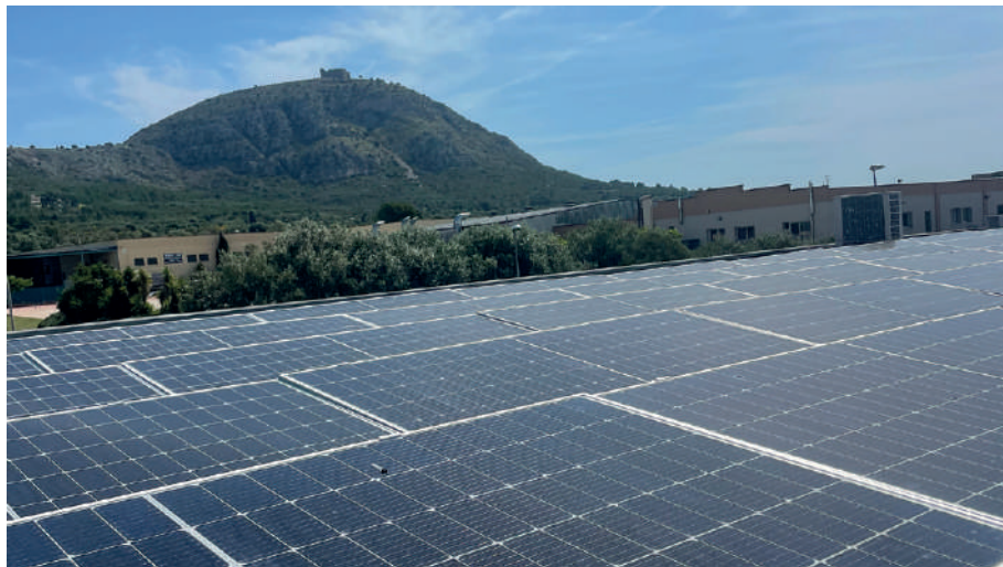
Coberta de l'ajuntament on s'ha fet la instal·lació de 35 kWp
