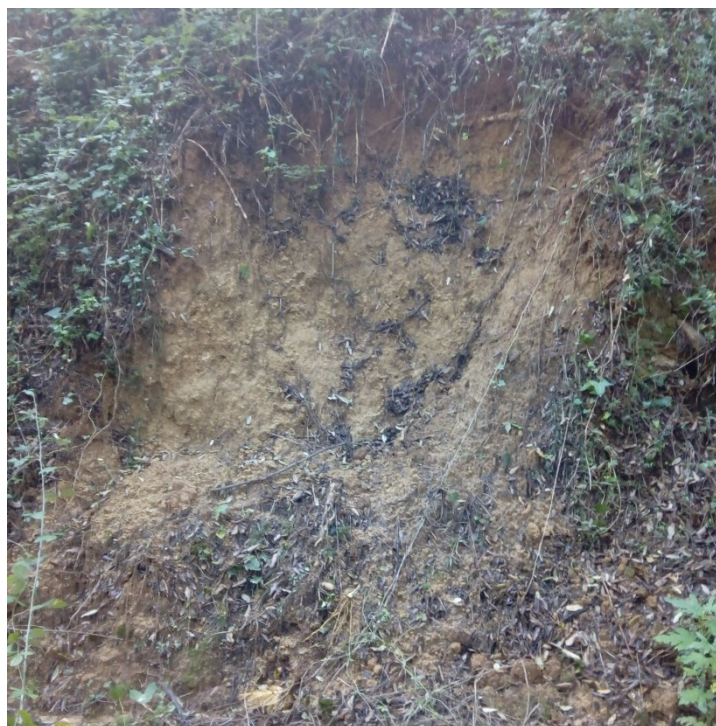
Fotografia 1. Detall d'una de les esllavissades del talús del Carrer de Baix a Saus, conseqüència de les pluges de finals d'Octubre de 2019.
