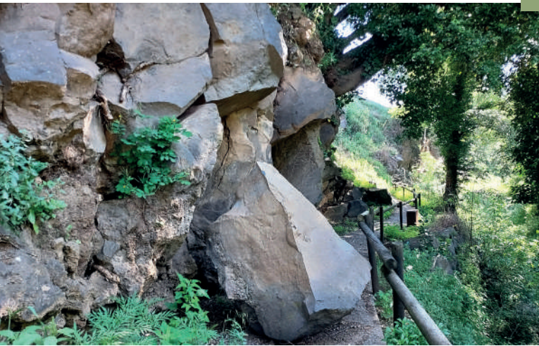
SALVADOR SARQUELLA FOTOGRAFIA 8 . Desprendiment del basalt
