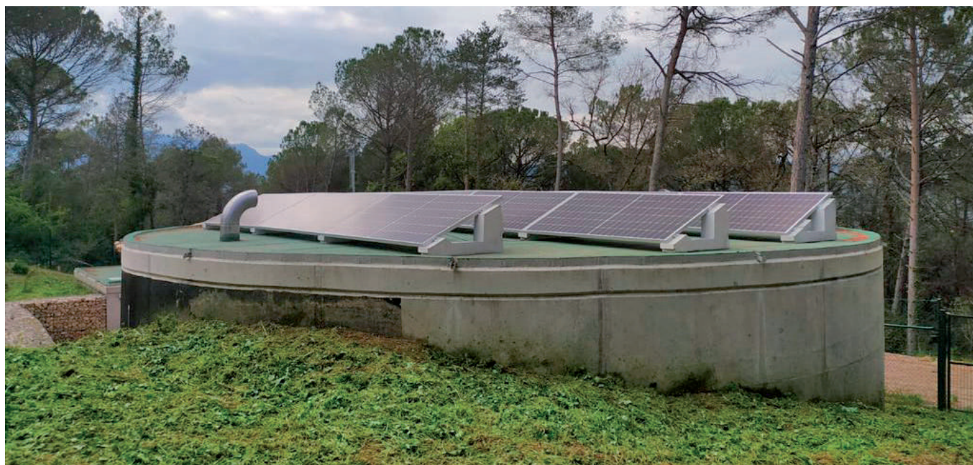
Instal·lació fotovoltaïca pel dipòsit municipal d'aigua.
