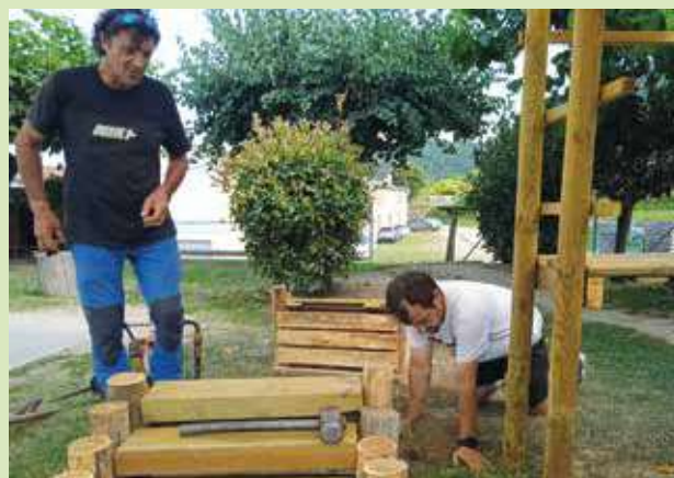
Construcció de l'estructura de l'exterior d'en Talledes i d'en Joan (avi i pare del'Ànnia Bosch) Estiu 2024
