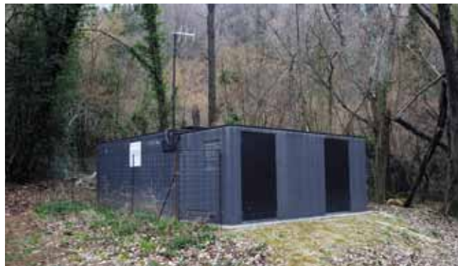
Dipòsit d'aigua potable de Sant Iscle de Colltort
