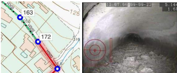
Figura 8. Localització quarta ingerència (esquerra) i canonada amb presència de dipòsits i d'arrels (dreta).
