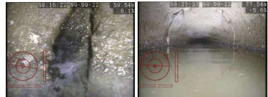
Figura 10. Defecte en una junta (esquerra) i col·lapse de la canonada (dreta).
