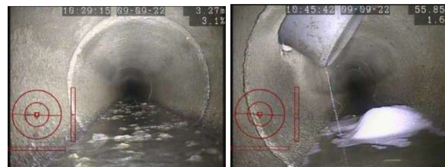
Figura 14. Dipòsits fins i gruixuts (esquerra) i connexió defectuosa (dreta).
