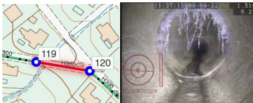
Figura 12. Localització ingerència (esquerra) i canonada amb arrels a les juntes (dreta).
