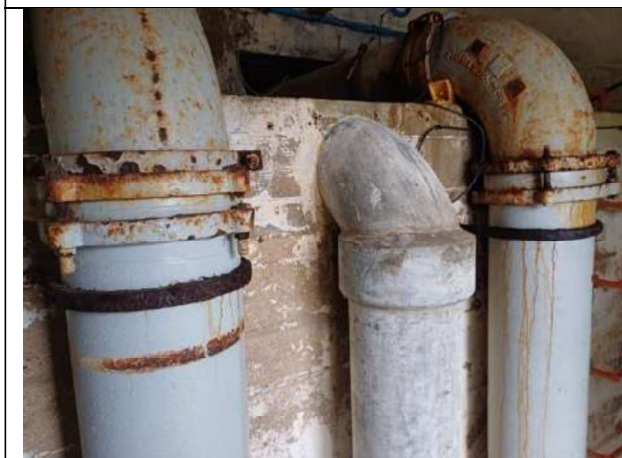
Fotografia 21. Conduccions entrada i sobreexidor
