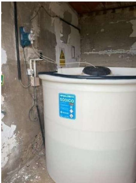
Fotografia 29. Dipòsit emmagatzematge de clor i bomba dosificadora
