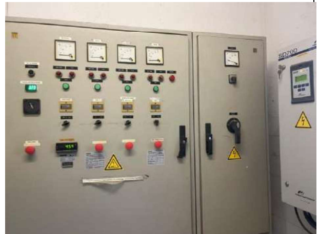
Fotografia 12. Armari elèctric i variadors bombes
