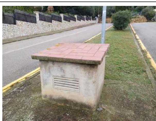
Fotografia 70. Ventilacions arqueta bombament
