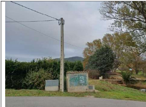
Fotografia 32. Vista caseta remota de control
