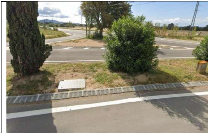
Fotografia 37. Arqueta conducció a Pau
