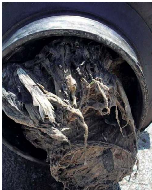
Manyoc de draps bloquejant el funcionament d'una bomba d'impulsió cap a Terri.
