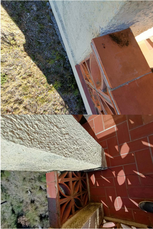
Imatges d'algunes esquerdes degut als assentaments diferencials amb el terreny
