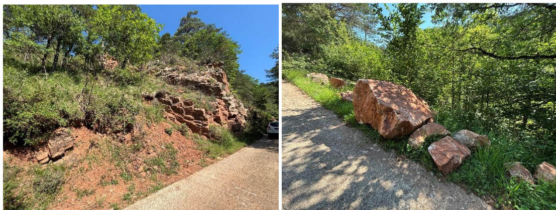
Figura 2. Estat actual del talús objecte d'actuació (esq.) i efectes de les esllavissades a l'altre banda de camí (dreta)
