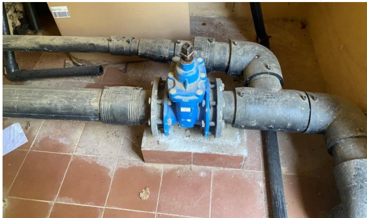
Fotografia 9. Vista detall de les canonades del sobreexidor i de purga de fons.
