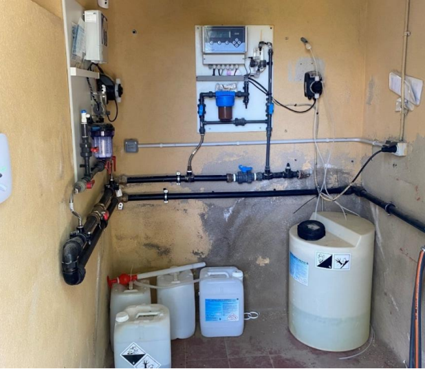
Fotografia 6. Vista general de la sala de cloració del Dipòsit de Juià.
