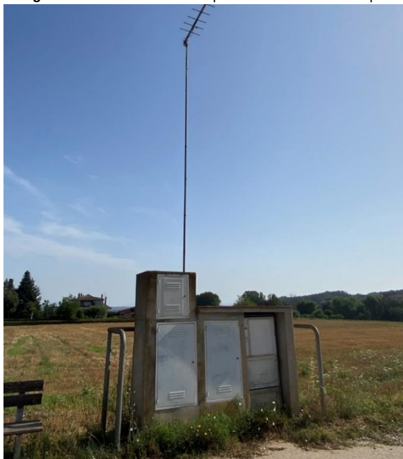
Fotografia 2. Vista exterior dels quadres elèctrics de la captació.
