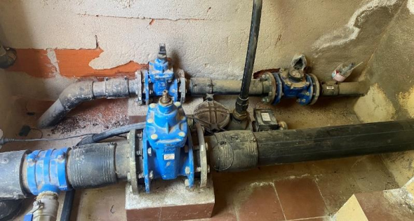
Fotografia 4. Vista detall de la canonada d'entrada al Dipòsit de Juià.
