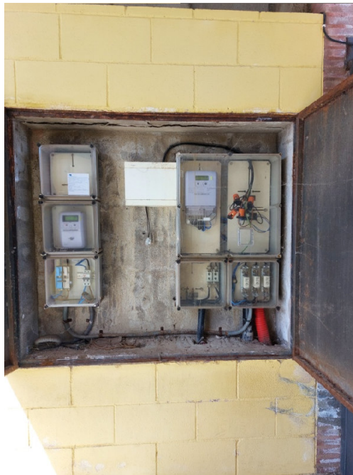
Comptador existent situat en porxo entrada a l'edifici
