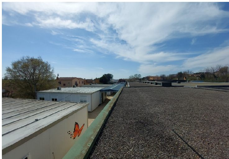
Coberta superior, en la qual se situa el camp fotovoltaic
