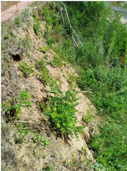
Zona de desprendiments.
