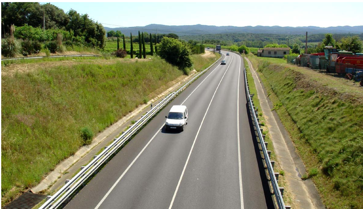
Marges verticals estables en un tram de la carretera A-2 quan va en trinxera en n tram proper al nucli urbà.
