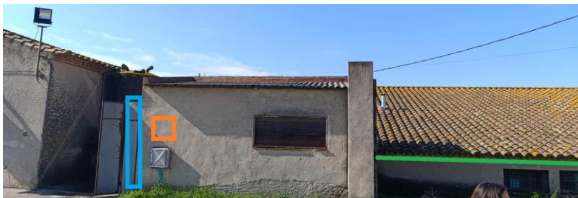
Il·lustració 10. Pas del tram de CA fins al transformador dins la caseta (taronja) i els armaris TMF10 (Blau)
