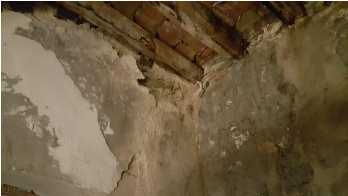
FOTOGRAFIES DE L'ESTAT FORJAT COBERTA EN ESTAT MOLT DEGRADAT
