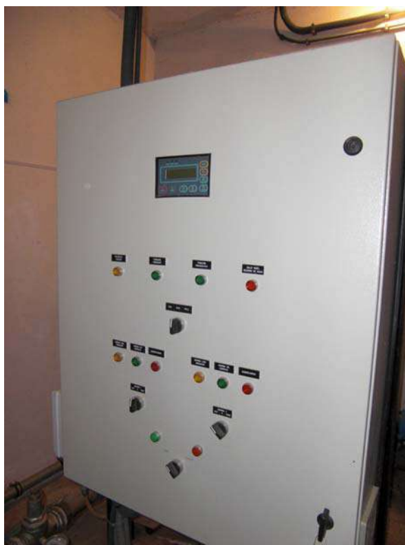
Foto núm.12 – Vista del quadre elèctric del grup de pressió.
