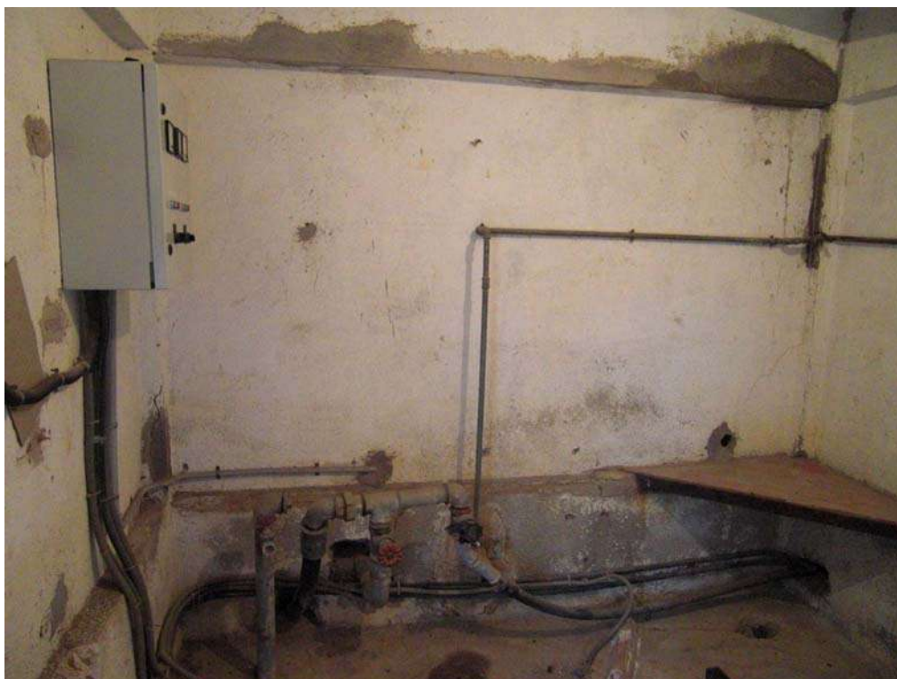
Foto núm.2 – Vista de l'interior de la caseta del pous I i II.
