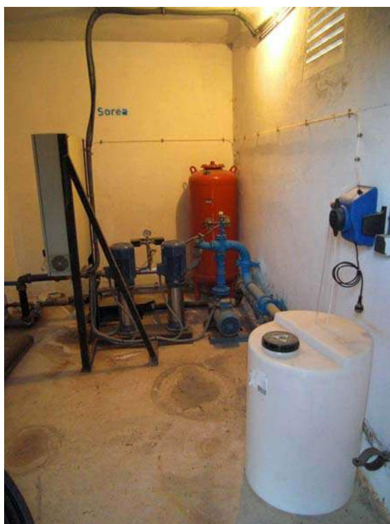
Foto núm.10 – Vista general de l'interior de la caseta del grup El Ventador.
