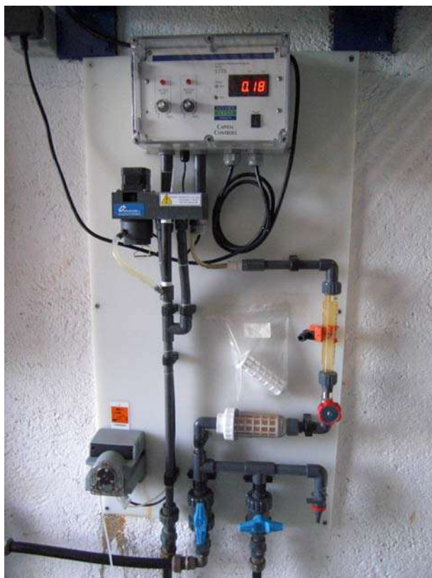
Foto núm. 7 – Vista detall del sistema de cloració automàtic.
