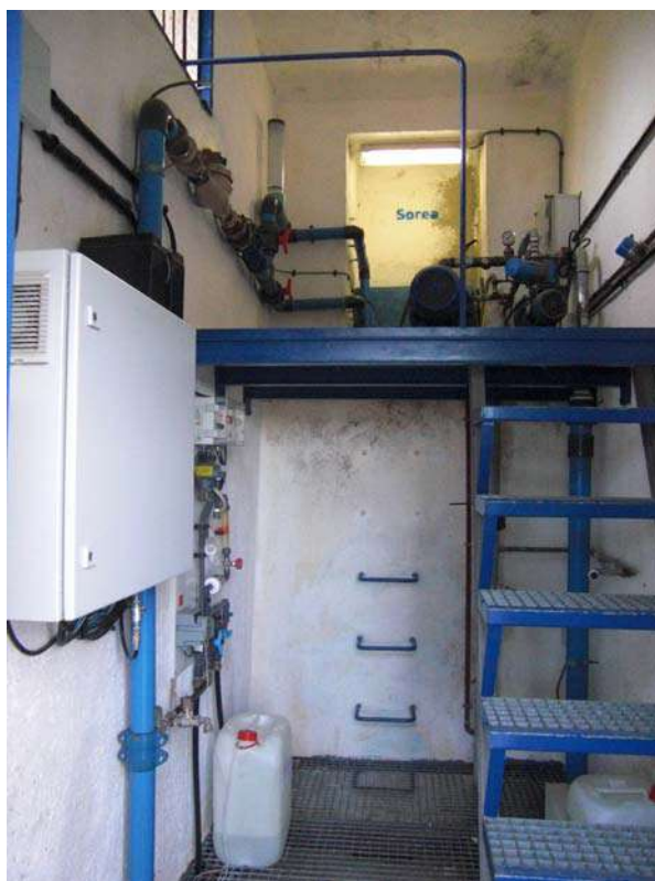
Foto núm. 6 – Vista de l'interior de la caseta del dipòsit. A la part inferior el sistema de cloració automàtic.
