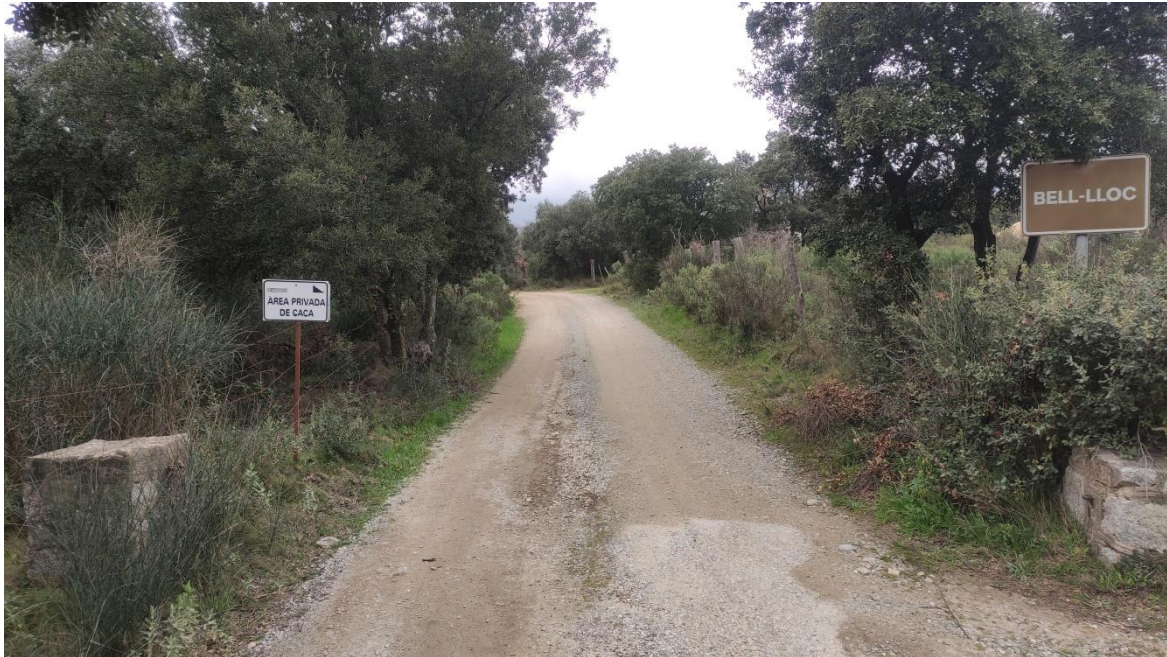
Fotografia 6. Final del tram asfaltat del camí històric de Cantallops a Bell-lloc.
