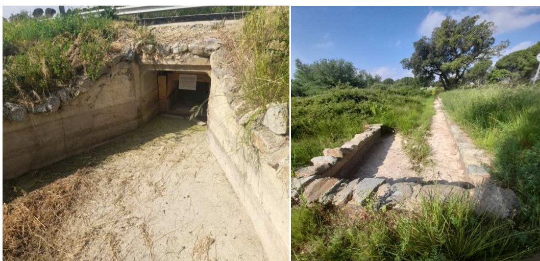
Foto 30- pas per a fauna aquàtica i herpetofauna a l'estany de la Cardonera. Foto 31- recollidor lateral per tal d'evitar atropellaments
