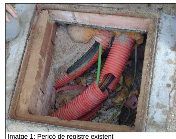
Imatge 1: Pericó de registre existent
