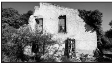
Estat actual del Mas Rimaló, prop de Maçanet de Cabrenys. Servi com a punt de suport dels guies de pas. Fotografia: Aniol Escorihuela
