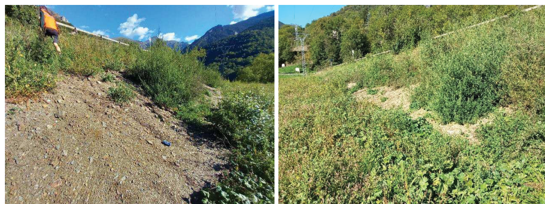
Figura núm. 21. Evidències de xaragalls al terraplè sota l'aparcament inferior.
