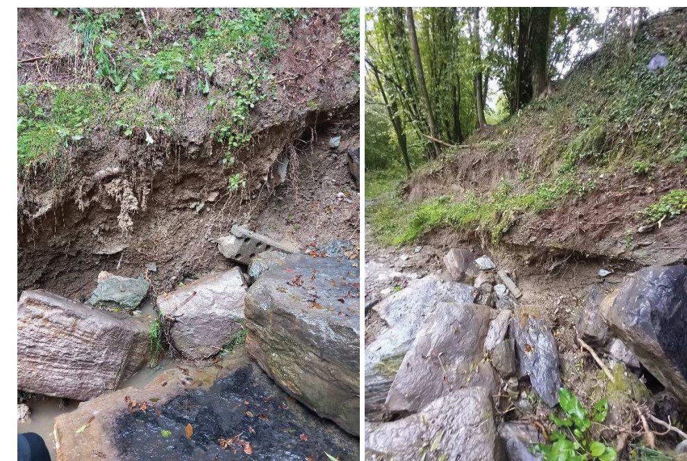
Figura núm. 14. Detall de l'erosió contacte terreny-mur d'escullera i descalçament de peces.
