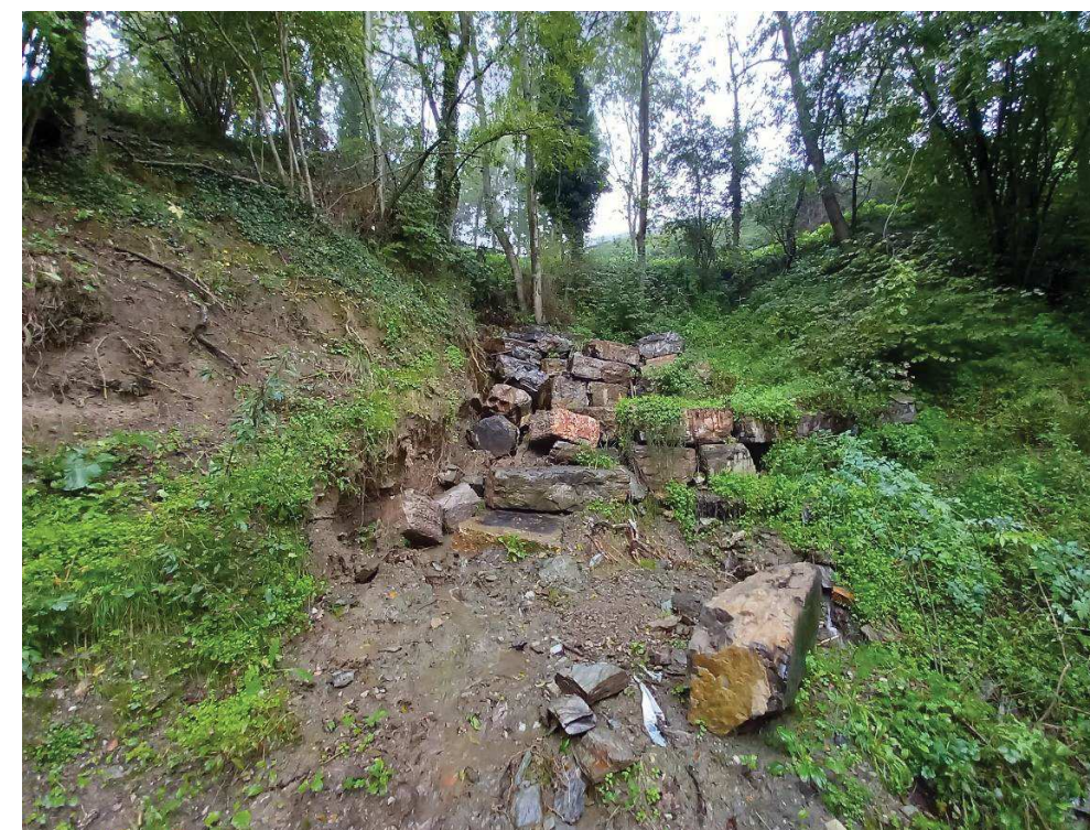
Figura núm. 13. Aspecte general de les patologies per erosió del terreny i descalçament de peces.
