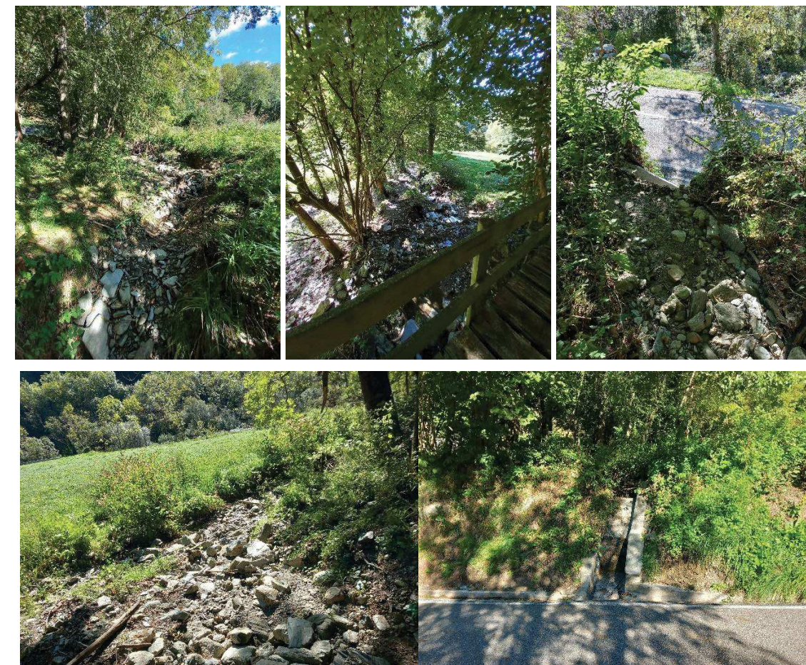
Figura núm. 11. Imatges dels dipòsits de sediments acumulats a la part baixa del torrent fins al tram canalitzat a l'OD localitzada al PK 4+900 de la carretera GIV-5217.
