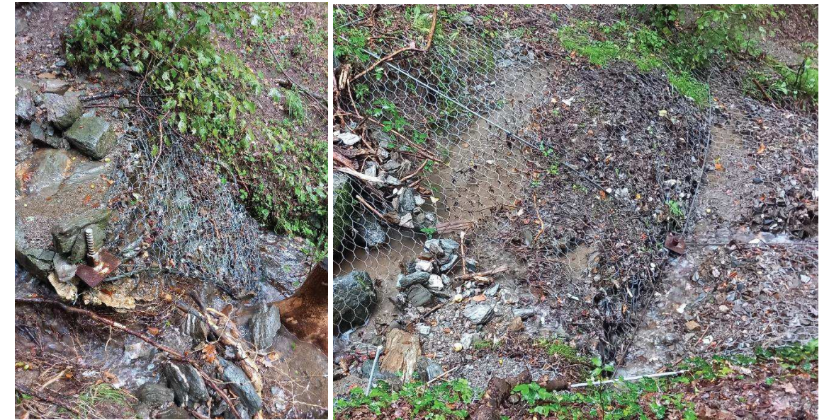
Figura núm. 17. Plaques de repartiment amb signes de rovellament.
