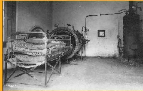
Instal·lació d'energia a l'Hospital. Muntat Dargatzis. Any 1910-1914. Fundació Masnou. Generalitat de Girona.
