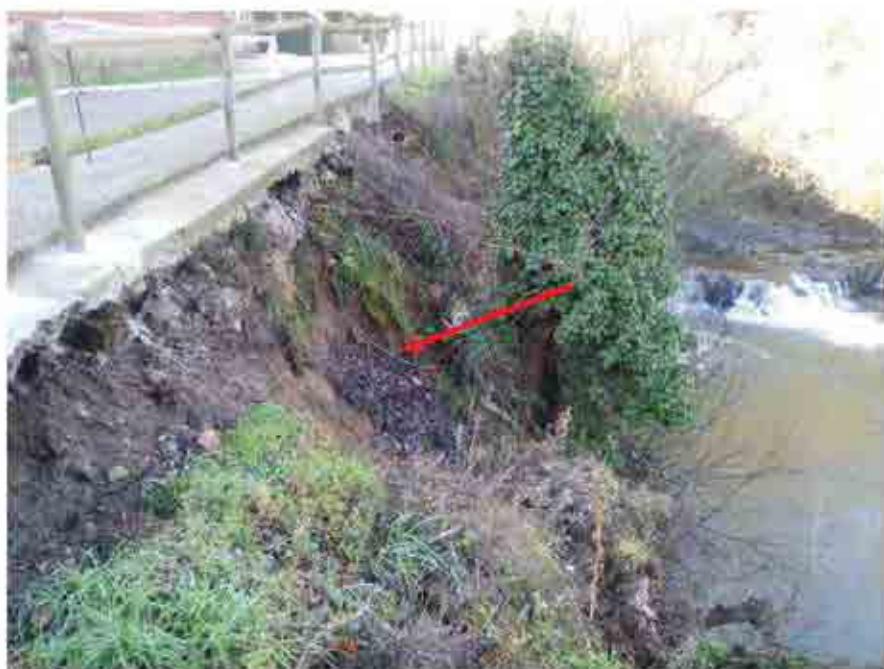
Figura 4. Zona on s'ha produït els desprendiments i esllavissada
