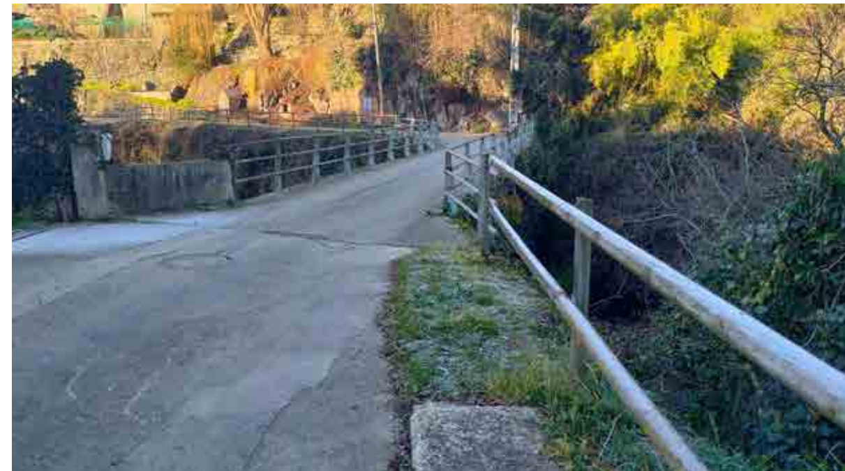
Fotografia 6. Vista de la zona de transició al pont sobre el riu Fluvià.
