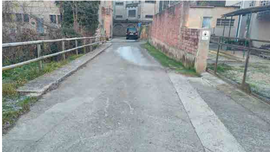
Fotografia 3. Vista general de camí de Can Porxes en la zona de l'esllavissada.
