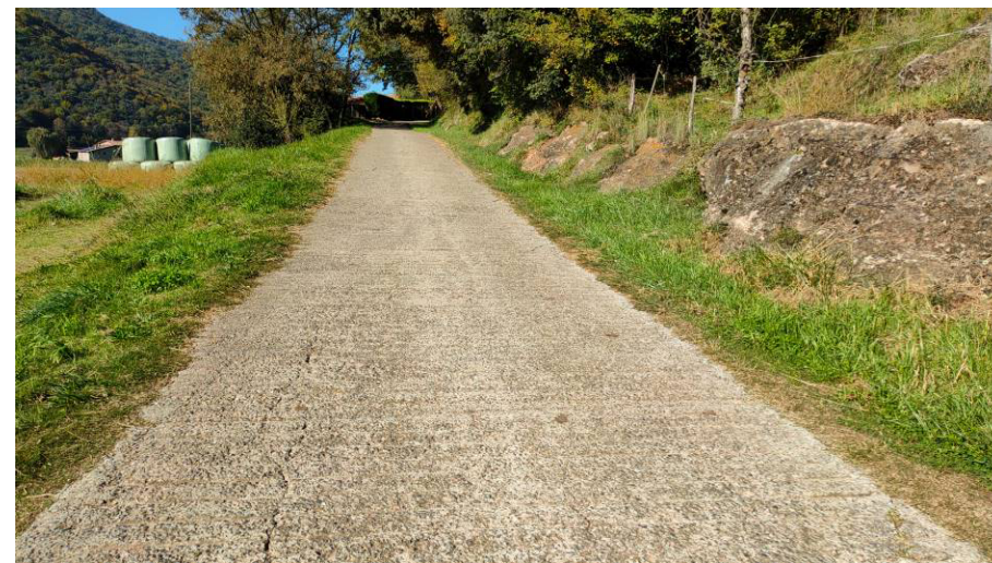
Fotografia 4. PK 2+230. Vista del ferm de formigó en mal estat.
