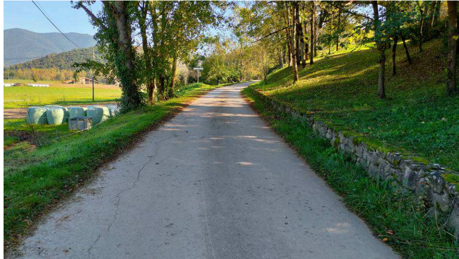
Fotografia 5. PK 2+500. Vista de la capa de rodadura en mal estat.
