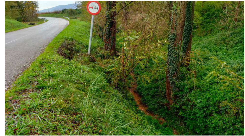
Fotografia 14. Vista de la situació actual del talús amb esllavissades. (PK 1+000).
