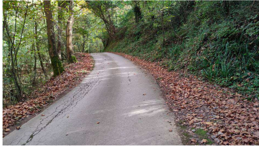
Fotografia 9. PK 3+600. Vista del ferm amb presència d'esfondraments.
