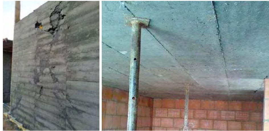
Figura 95. Diferents tipus de defectes en el formigó. Font: Pròpia / Curs MOOC - Introducció a los encofrados y las cimbras en obra civil y edificación.
