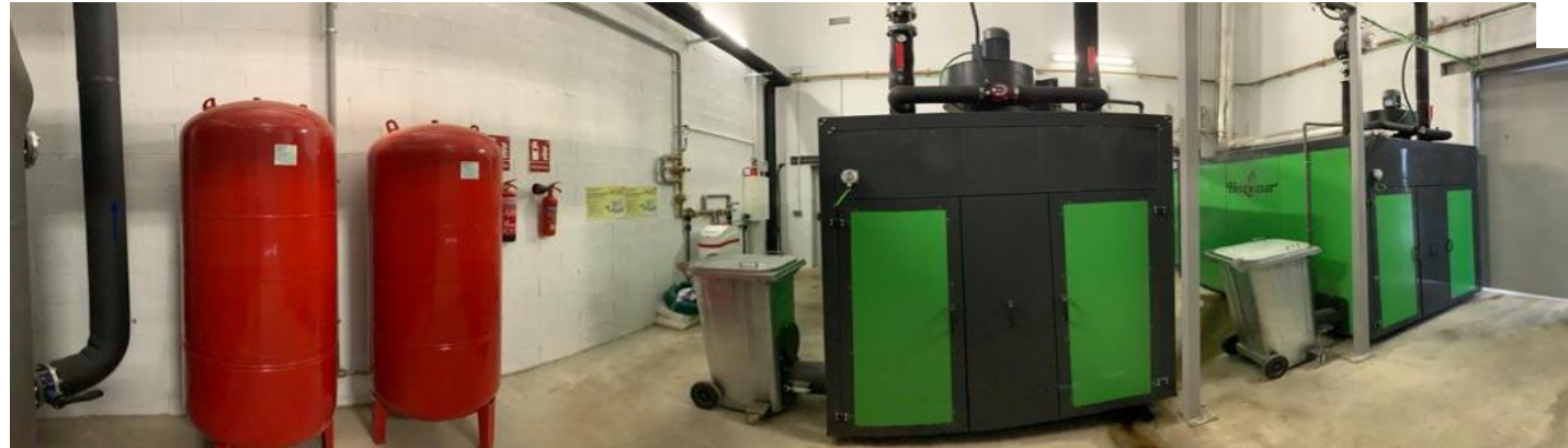
Sala de calderes de la piscina municipal i pavelló de Roses 600 kW
