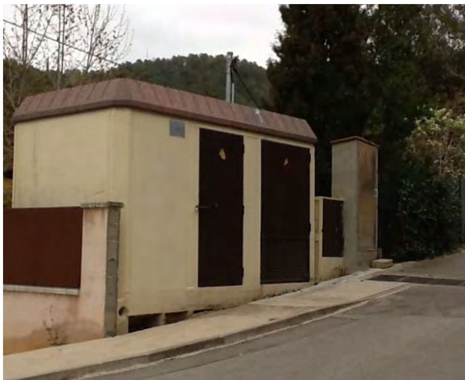
Imatge 3: Centre de Transformació DGI-51 a connectar noves línies subterrànies MT
