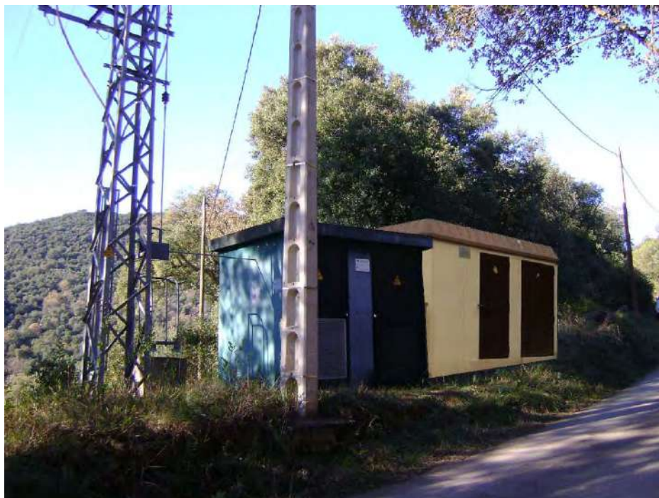
Imatge 1: Vista de la nova ubicació del nou CD DGI-10 "CAN GATZIU"
