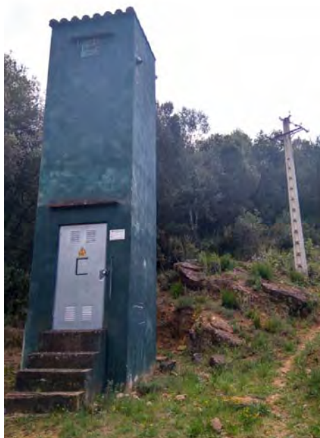
Fotografia 2: Centre de Transformació DGI-36 "Llorà Nord" a desmuntar
