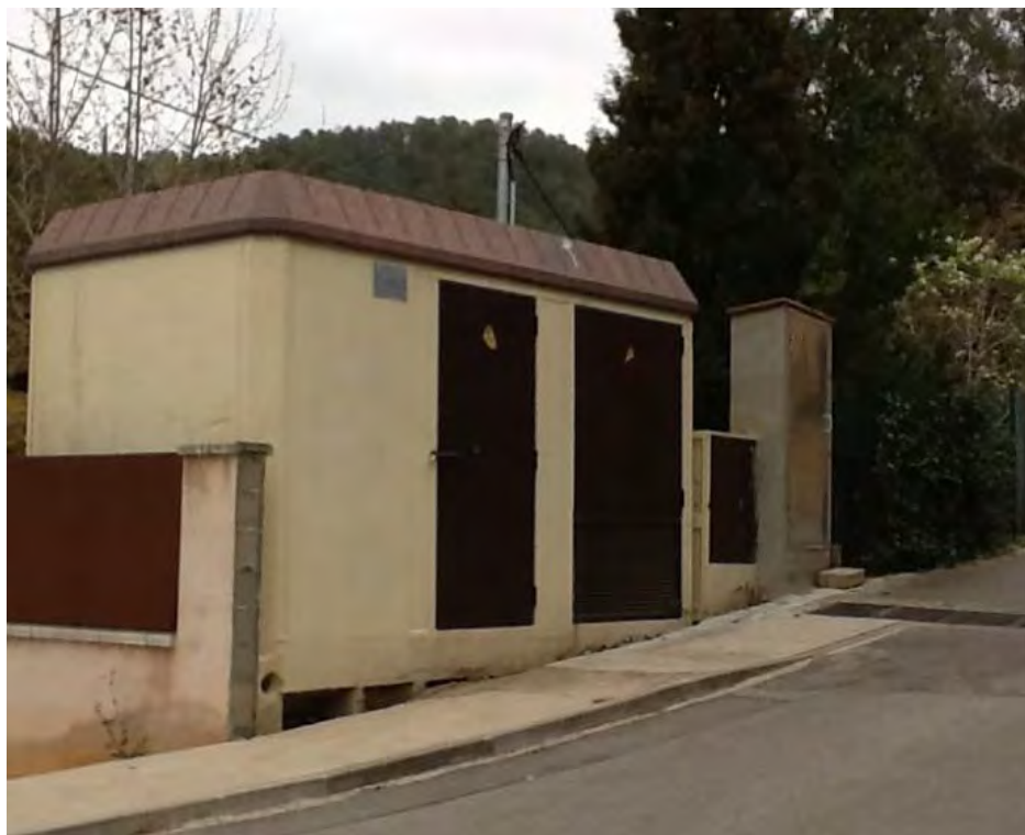
Fotografia 3: Centre de Transformació DGI-51 a connectar noves línies subterrànies MT
