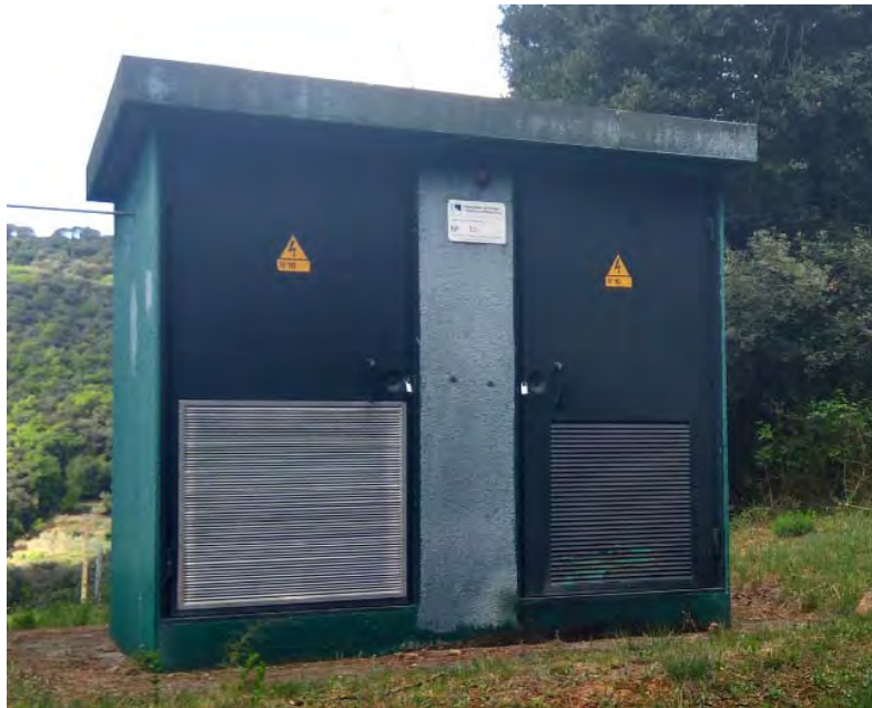
Fotografia 1: Centre de Transformació DGI-10 "Gatziu" a desmuntar
