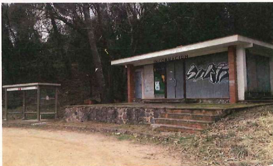
Originalment edificada com a oficina de vendes, la junta de compensació del sector n'ha realitzat les tasques mínimes de manteniment per evitar-ne l'enderroc i permetre'n una futura utilització com a equipament social i/o cultural.
