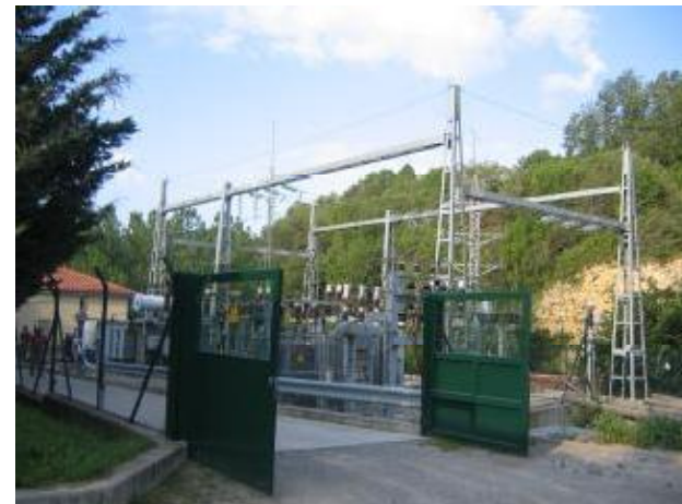
Central hidroelèctrica de Sant Pau de Segúries
