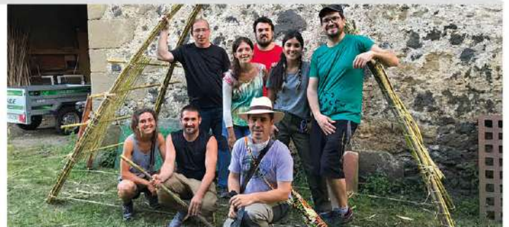
Pràctiques màster Bioconstrucció a la masia del Junquer. Ecoarquitectura Gabi Barbeta - Udg)
