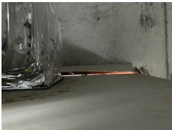
Foto: punt d'infiltració aire a la sala
