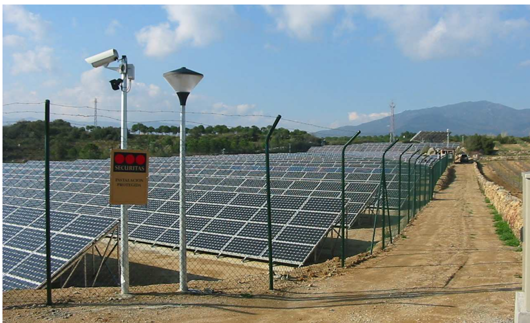
Parc solar a Capmany
