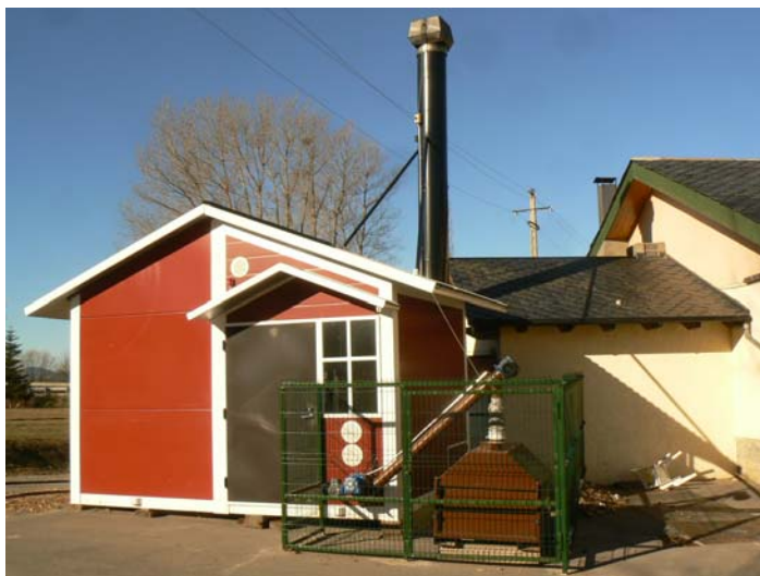
Foto. Central de biomassa situada en una de les escoles
