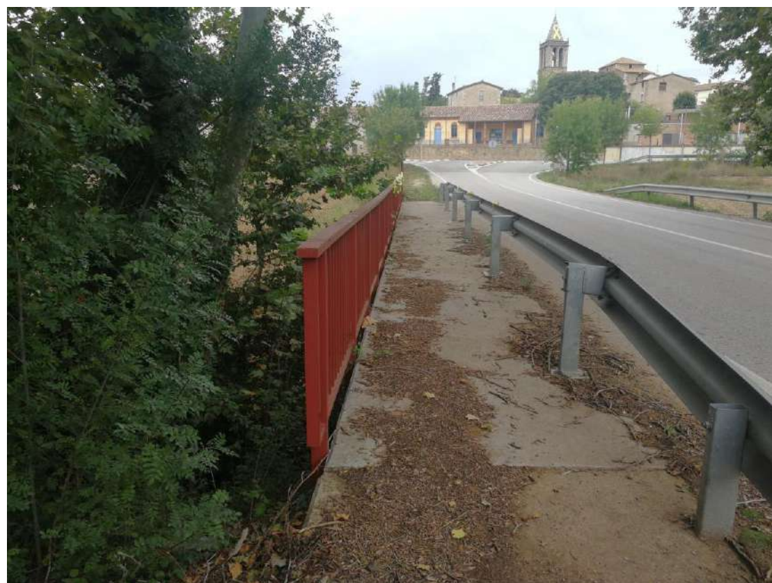
Imatge 6: Pas actual sobre el pont de Can Garrofa en el seu costat oest, per on transcorrerà la Via Verda.
