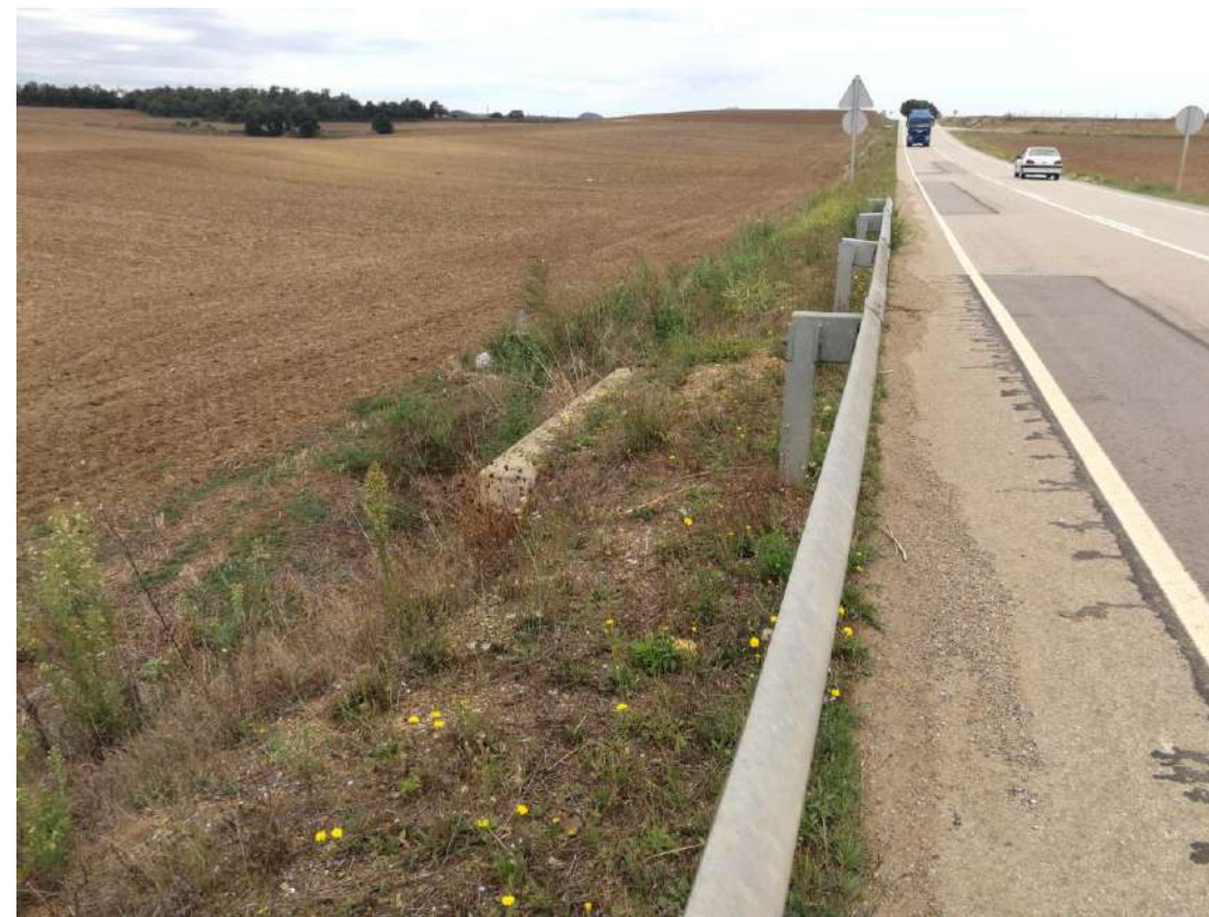
Imatge 15: Desguàs al pla de Ca n'Arbres al PK 3+400 de la carretera. Vorera oest en sentit nord.
