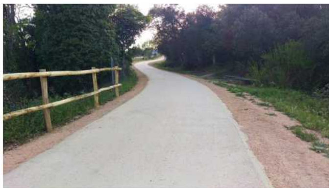
Imatge 6.- Paviment de sauló estabilitzat executat a la via verda del carrilet
